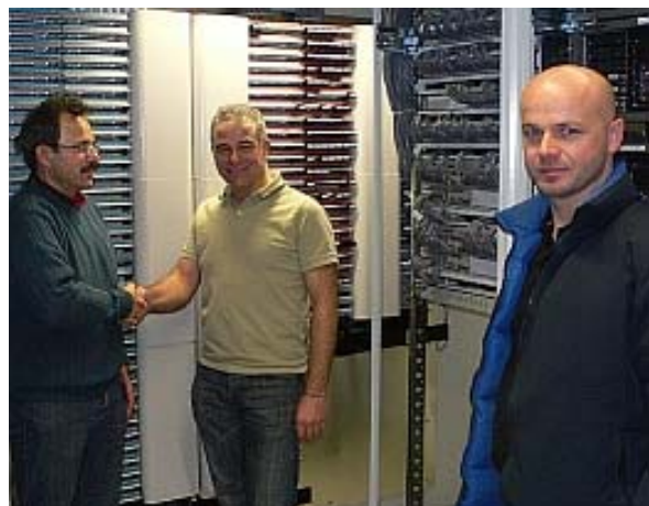
Die Projektverantwortlichen von Syscom und der Lebenshilfe Tirol im neuen Serverraum der LH-Zentrale
